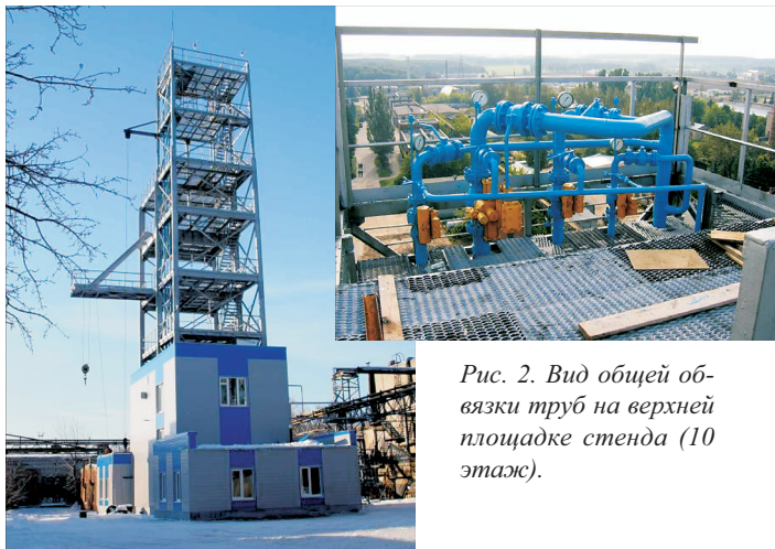
Рис. 1. Стенд по отработке технологий эксплуатации газовых скважин на поздней стадии разработки (внешний вид).
