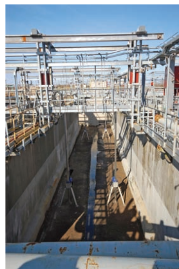
Рис. 9. Аноксидный реактор с механическим перемешиванием иловой суспензии, оснащенный придонными пропеллерными перемешивающими устройствами (ООО «Кинеш», г. Кириши).
