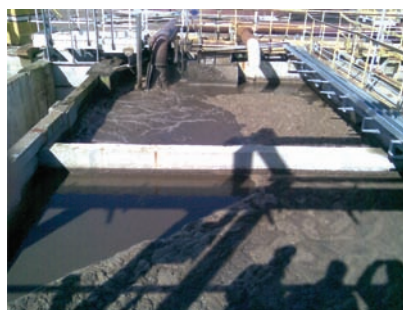
Рис. 8. «Анаэробная зона», переходящая в аноксидную зону очистных сооружений.
