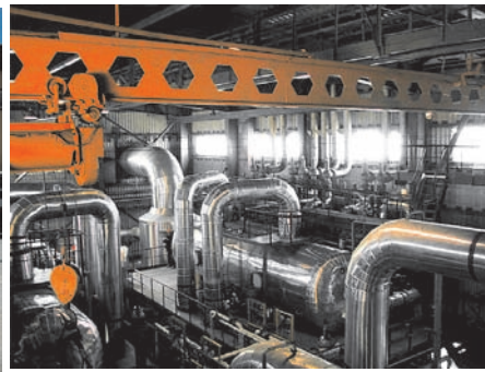
Рис. 4. Мутновская ГеоЭС. Сепараторный зал. (Фото В. Сваловой).
